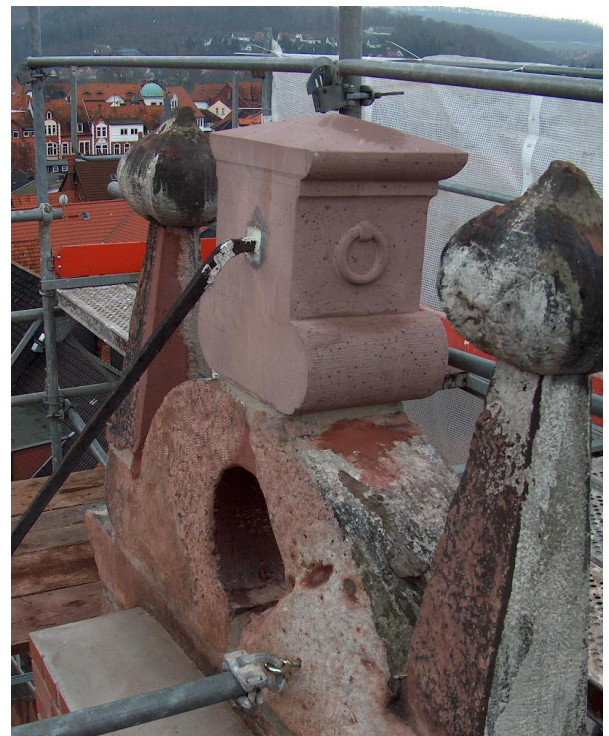
Neuer, aus rotem Wesersandstein gefertigter Bekrönungsaufsatz auf dem Westgiebel, der das durch korrodierte Eisenanker völlig zersprungene, identische Originalstück ersetzt.
